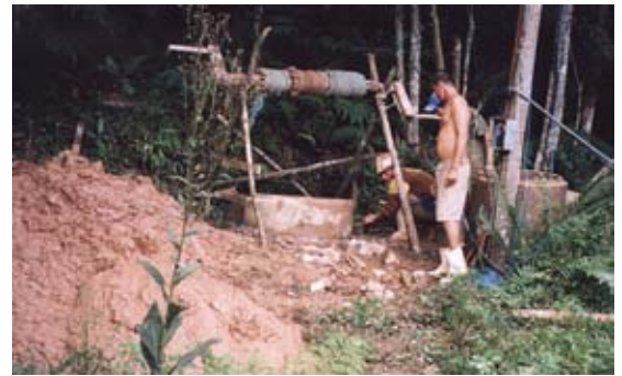
Brunnenspezialist Edson saniert mit Bruder und Cousin während einer Woche unsere Hauptquelle. Links der herausgebuddelte Erdschlamm.
